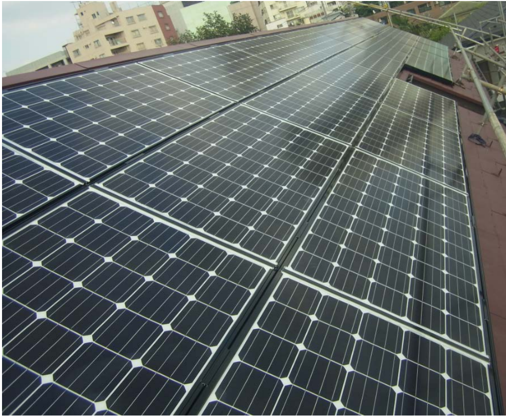
太陽光発電パネルを屋根南側全面に設置
