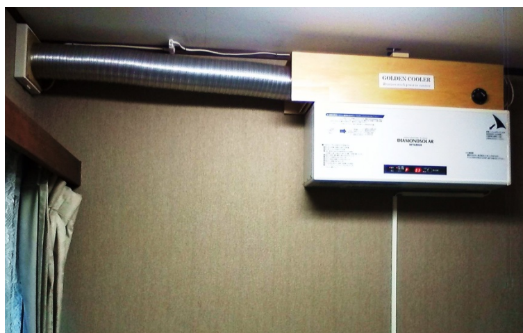
室内用パワーコンディショナーと夏期空冷増力装置
