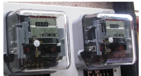
電力計 消費電力用 発電電力用
